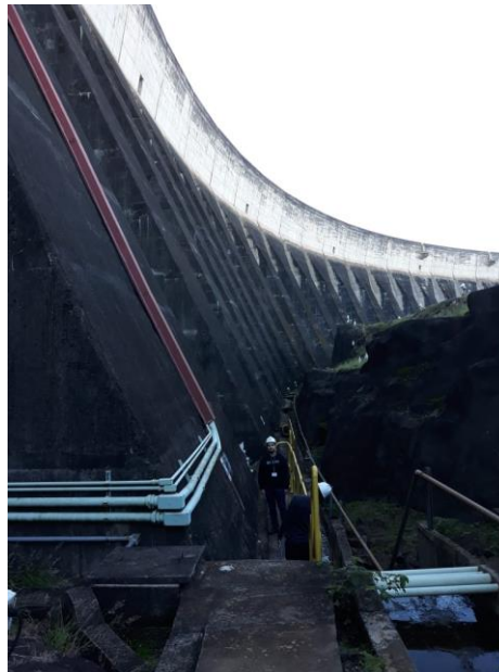
Figura 1. Perfil a jusante do Bloco de Contraforte D-38.
